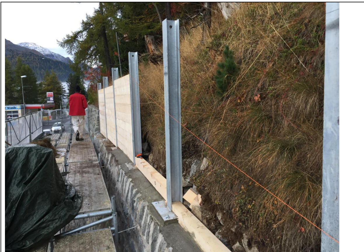
Abb.: Palisade beim Einlegen der Holzbalken, welche die Verkehrsteilnehmer vor Rieselschutt aus der bergseitigen Böschung schützen sollen (Bauamt St. Moritz)
