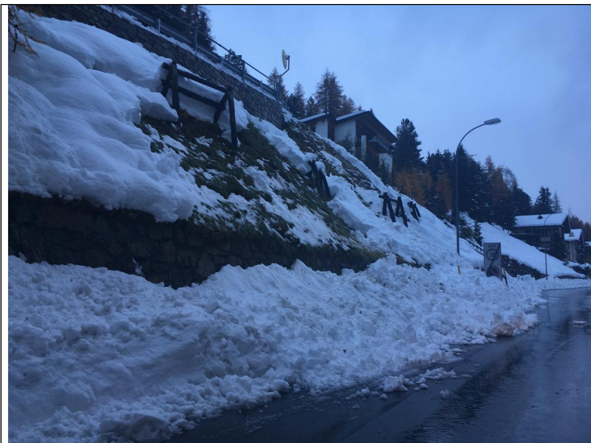
Abb.: Gleitschneeereignis auf die Via Somplaz (Bauamt St. Moritz)
