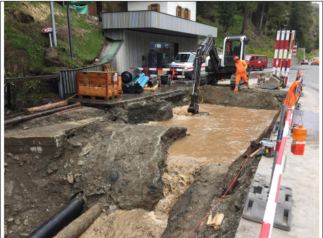
Abb.: Ein Leitungsbruch, der sich glücklicherweise während einer laufenden Sanierung ereignete, flutete zwar die Baustelle, doch verursachte für einmal keine Extra-Kosten (Bauamt St. Moritz)
