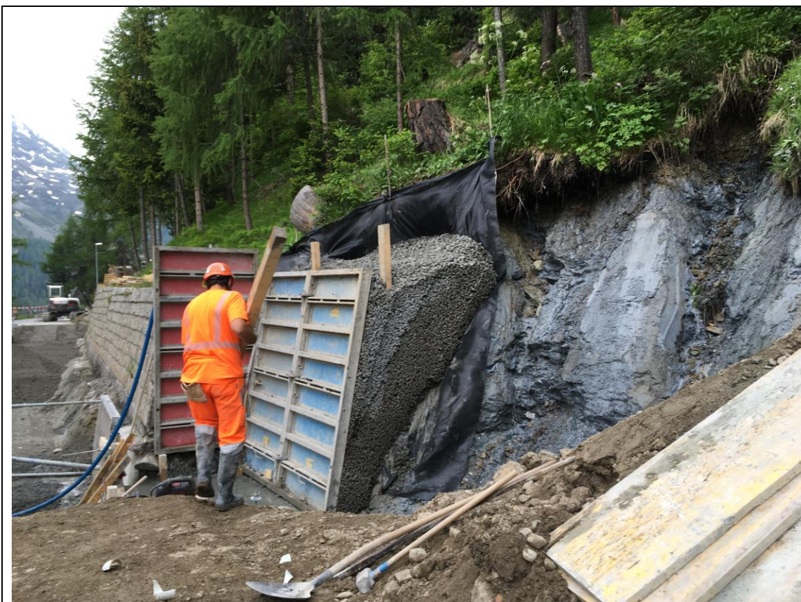
Abb.: Sicherung der Böschung mit dem verwitternden Suvretta Fels rechts (Bauamt St. Moritz)
