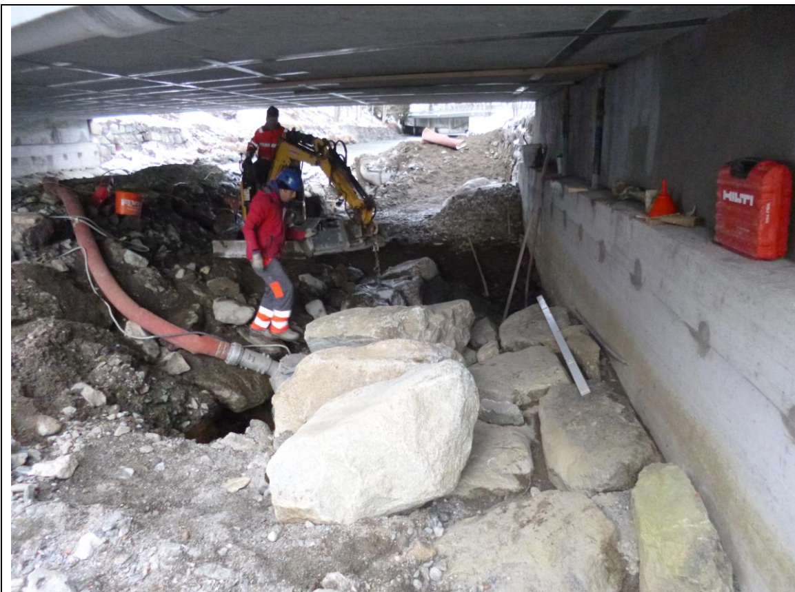
Abb.: Nach dem die Klebearmierung an der Unterseite der Brücke fixiert wurde, wurde der neue Kolkschutz eingebaut (Bauamt St. Moritz)
