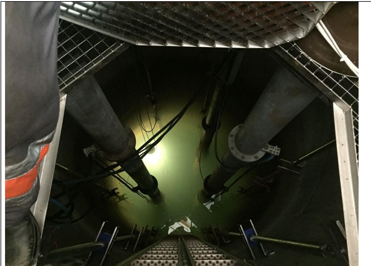
Abb.: Eintrübung im Grundwasserpumpwerk San Gian II (Bauamt St. Moritz)
